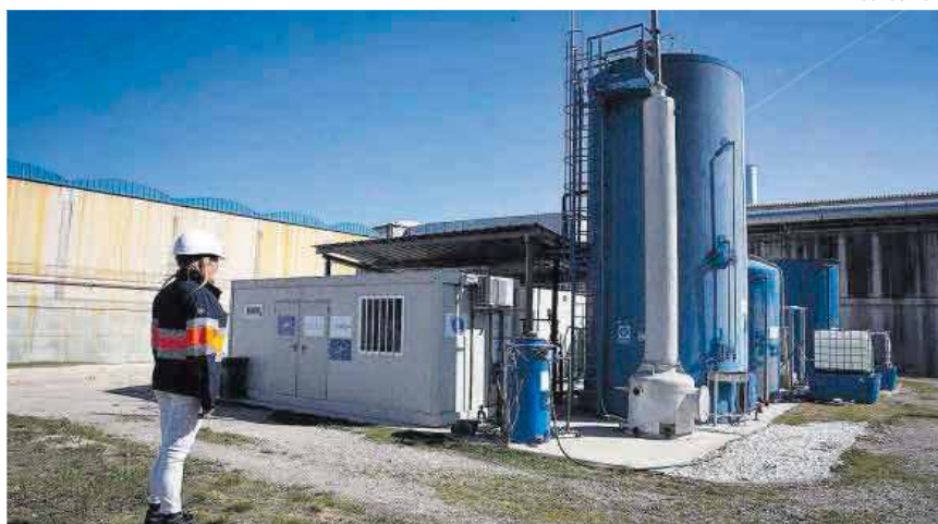
Planta experimental para el tratamiento del agua en la depuradora de Montcada i Reixac.
